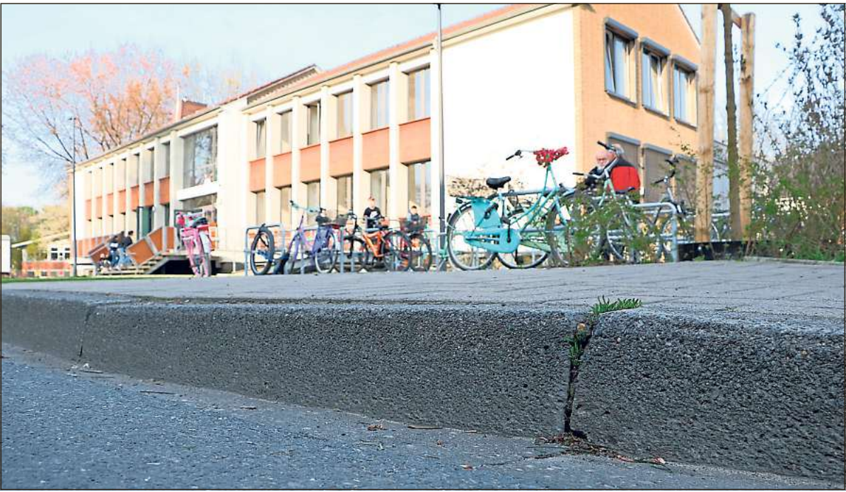
Der einzige Stein des Anstoßes am und im ansonsten barrierefrei umgebauten JuK-Haus in Ahlen: Manuela Esper wies auf die hohe Bordsteinkante vor dem Fahrradparkplatz hin. Bild: Wittmann
